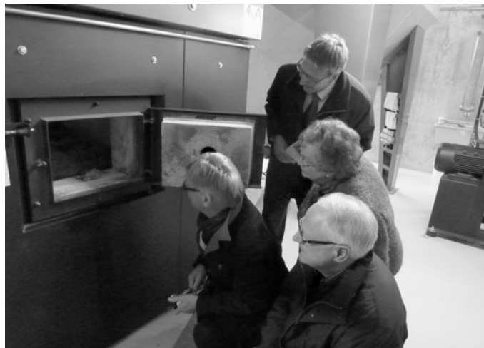
EIN BLICK IN DEN OFEN, IN DEM DAS DUFTENDE FRISCHHOLZ VERBRANNT WIRD.
