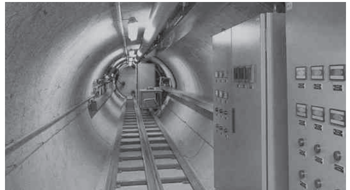
IM STOLLEN DES NAGRA-VERSUCHSLABORS GRIMSEL. DAS SICHERE EINLAGERN HOCHAKTIVER ABFÄLLE KANN HIER 1:1 SIMULIERT WERDEN.
